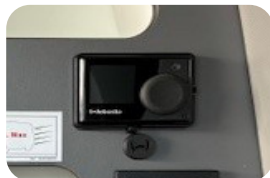
Regulador de la calefacción
