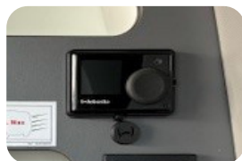
Comando di regolazione del riscaldamento
